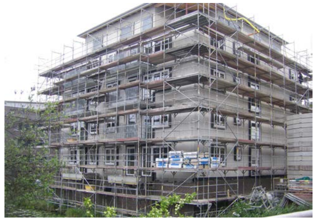
Bautenstand des ersten Wohngebäudes der Schlüsselbund eG im Sept. 2023 (Bild: STATTBAU HAMBURG)
